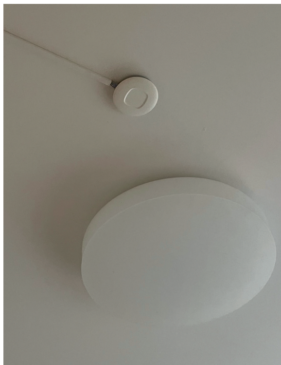
Sturzerkennungssensor an der Decke
